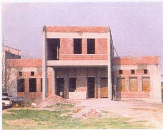
ΤΟ ΚΤΙΡΙΟ ΤΟΥ Β/Ν ΣΤΑΘΜΟΥ ΤΟΥ ΔΕΝΔΡΟΠΟΤΑΜΟΥ ΚΑΤΑ ΤΗΝ ΔΙΑΡΚΕΙΑ ΤΩΝ ΕΡΓΑΣΙΩΝ ΚΑΤΑΣΚΕΥΗΣ ΤΟΥ
